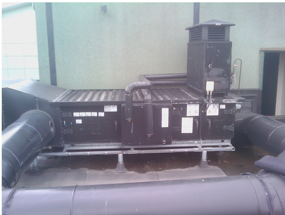
Figur 16: Frånluftsaggregat med återvinning.
