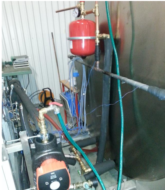
Figur 44. Köldbärarpumpen i förgrunden med anslutningsrör och expansionskärl i bakgrunden.
